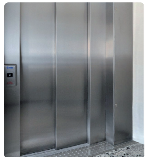
Türportal mit vorgesetzter Aufzugsteuerung
